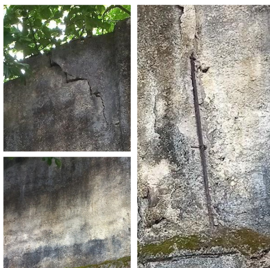
Figura 4 - Perda de seção da armadura, fissuras e manchas escuras. Fonte: Autores (2022).
