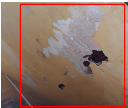
Figura 3. Destacamento da película de pintura e destacamento do reboco
