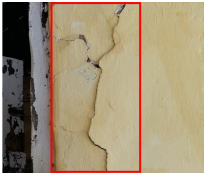
Figura 1. Fissura na parede próxima a uma das portas
