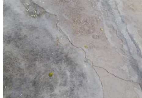
Figura 10. Fissuração do piso
