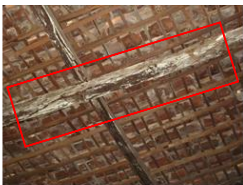
Figura 5. Terça de madeira com foco de cupim
