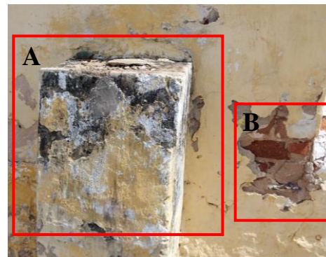
Figura 4. Mancha característica de vegetação parasitária (ponto A) e destacamento de argamassa (ponto B)
