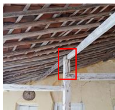
Figura 6. Pilar de madeira que dá sustentação ao telhado com foco de cupim
