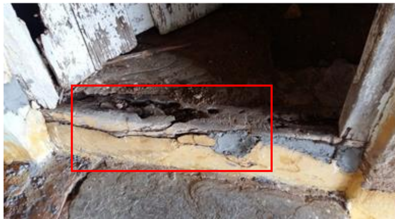
Figura 11. Deslocamento de fragmentos no piso e fissuração
