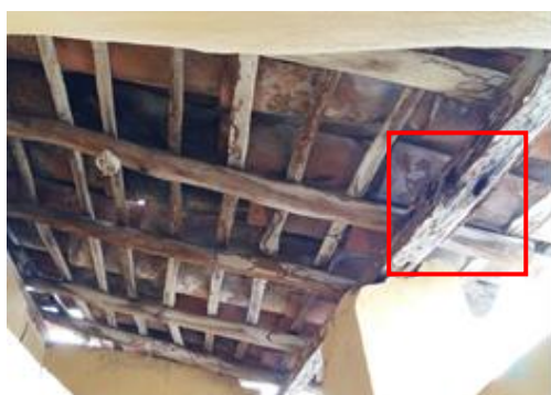
Figura 7. Presença de brocas na madeira do telhado
