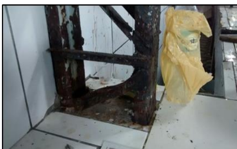
Figura 03. Pilar sofrendo oxidação.
