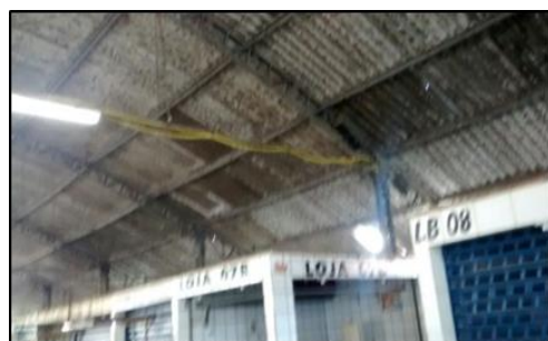
Figura 04. Coberta e instalações elétricas precárias.
